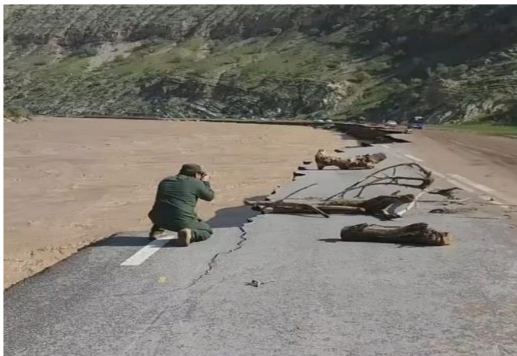
شکل ۱-۳۰- آب شستگی راه ارتباطی خرم آباد پلدختر مجاور رود کشکان
