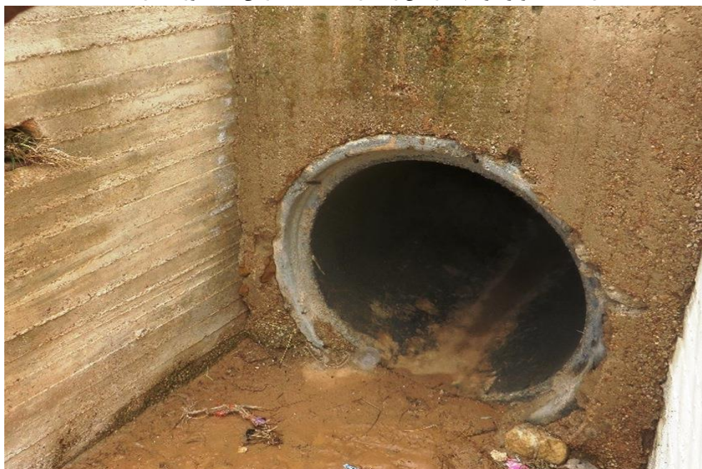
شکل ۲-۱۵ تصویر کانال طراحی شده با قطر یک متر جهت خروج سیلاب دروازه قرآن
