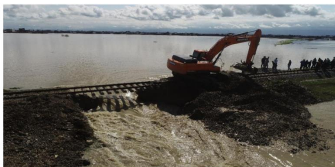
شکل ۱-۲ تخریب ریل راه آهن در غرب آق قلا برای تخلیه سیل
